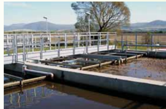
Čistička odpadových vôd Wastewater treatment plant Szennyvíztisztító
