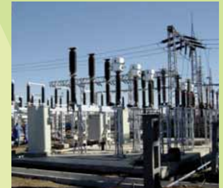
Elektrická stanica Elektromos állomás Power station
